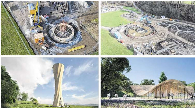
Wenn aus Baustellen architektonische Vorzeigebauwerke werden: Sowohl beim Aussichtsturm (linke Bilder) als auch beim Holz-Naturfaser-Pavillon (rechts) werden derzeit die Fundamente erstellt. (Fotos: Morlok/LGS)
