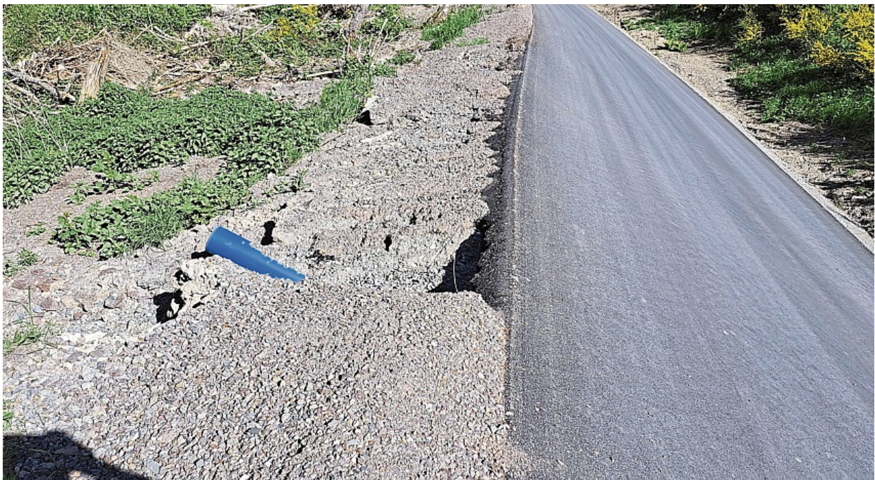
Gerade saniert, schon wieder in Gefahr: Der Asphalt auf der Kreisstraße 50 von Rhadern nach Fürstenberg ist zumindest an einer Stelle schon wieder unterspült, die Bankette nicht gescheit ausgeführt.
